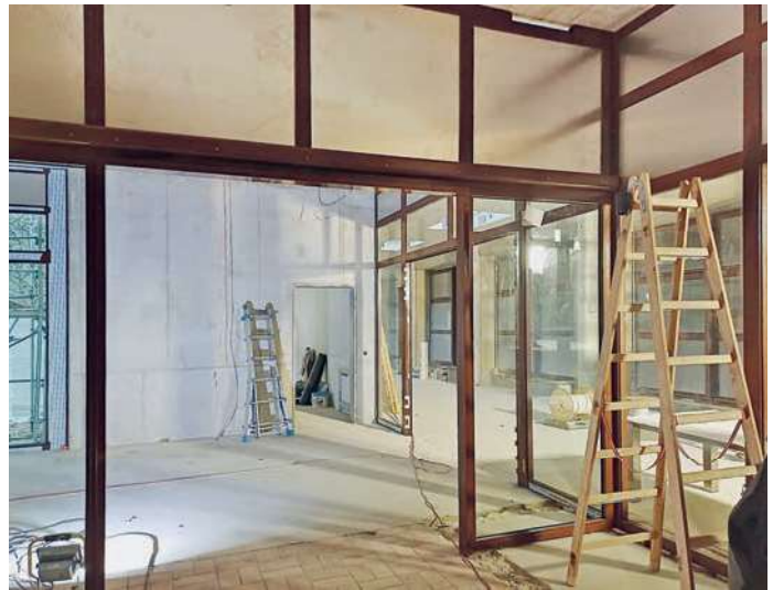
Die Fenster zwischen der Galerie und der Sporthallen Hallenbad werden im Februar 2025 ausgebaut.
