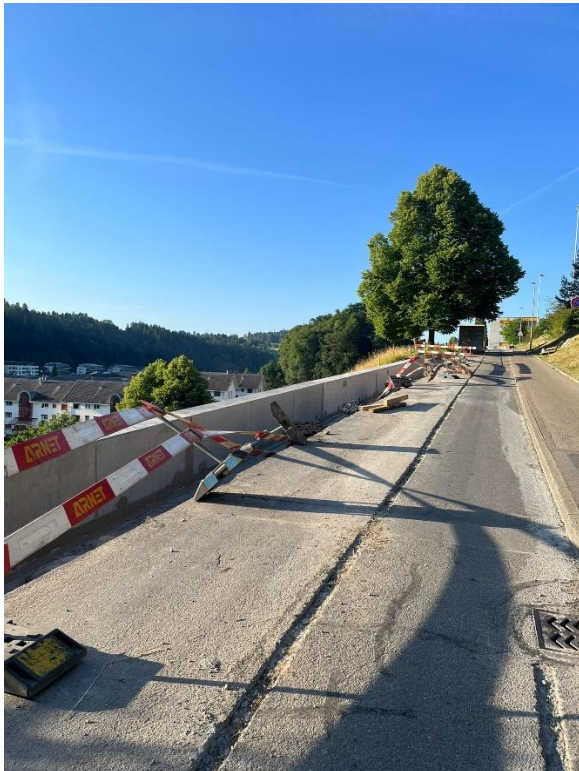
Bild: demolierte Abschränkungen
